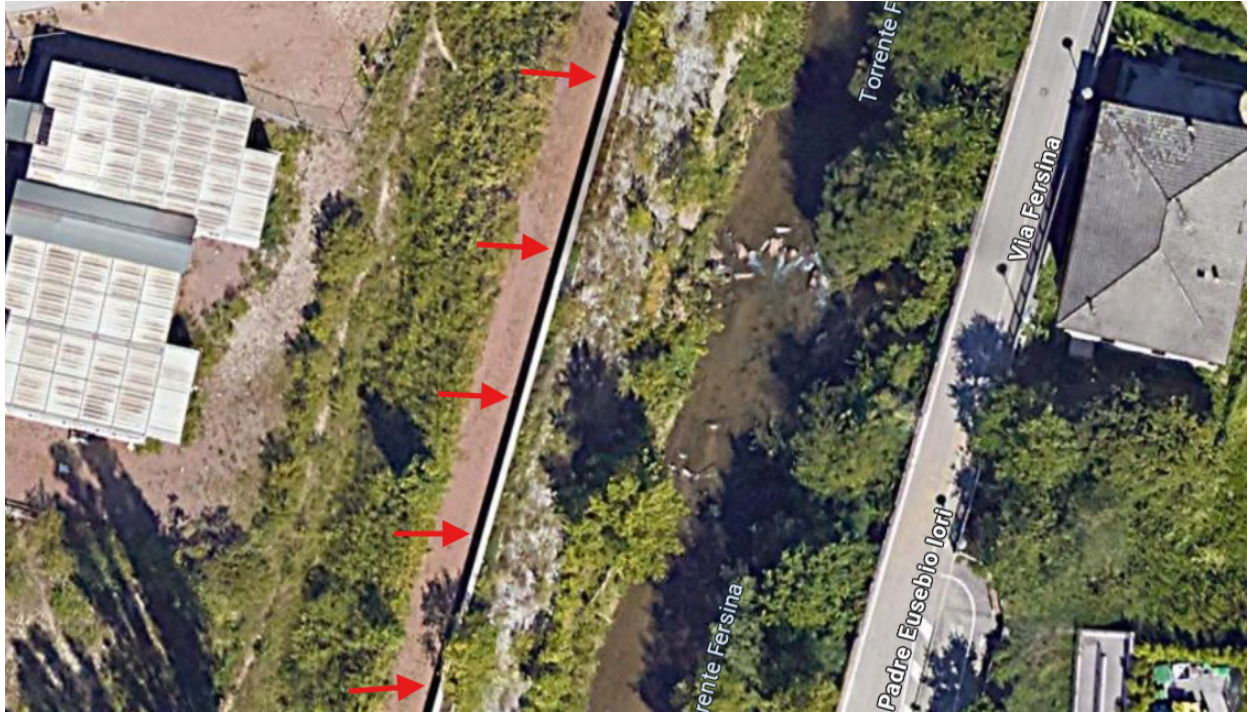
Figura 14: Muro di sponda molto sottile, in corrispondenza della fine del tratto, sponda sinistra. Non viene proprio rilevato dal DTM
